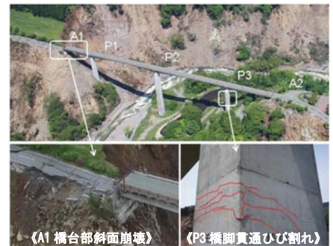
図-1 阿蘇長陽大橋の外景及び主な損傷 1)
