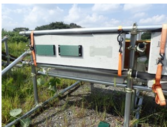
図-8 ベースプレートの脱落
