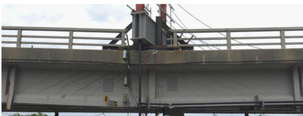
写真-2 破壊状況
