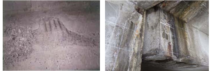
(a)U橋劣化状況(箱桁内部) (b)M橋劣化状況(桁端部) 写真-3 塩害劣化状況
