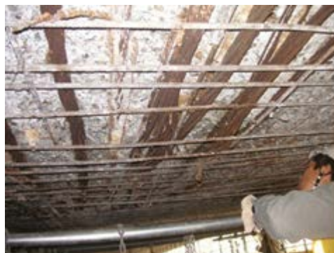
図-1 PC鋼材の腐食・破断
