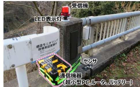
写真-3 通信機器の設置状況
